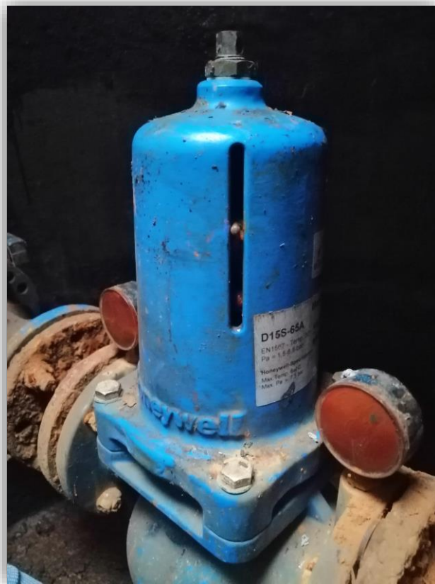
zawór redukujący ciśnienie przed wymianą
