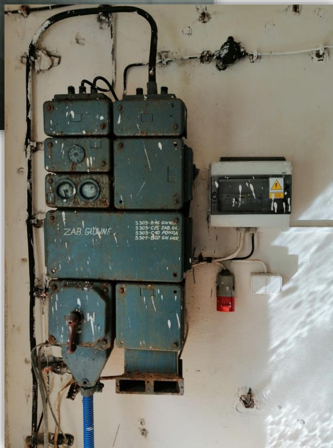
zbiornik wody nr 1
