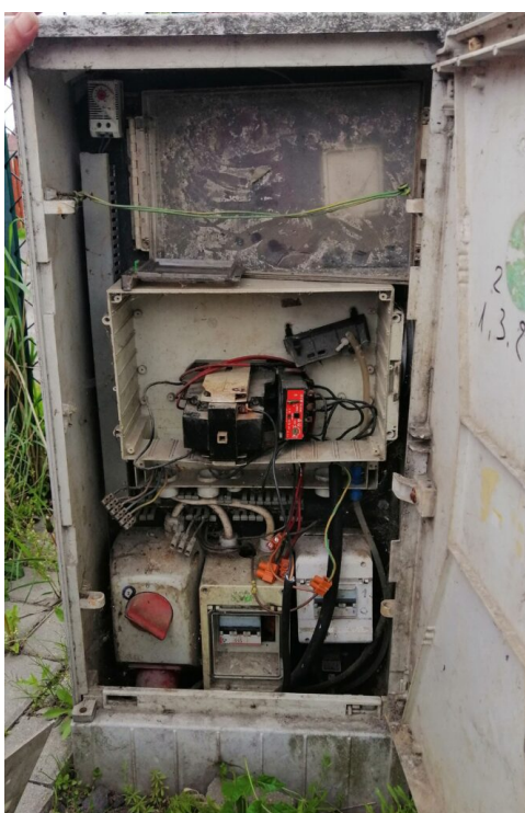
szafa przy ul. Pocztowej
