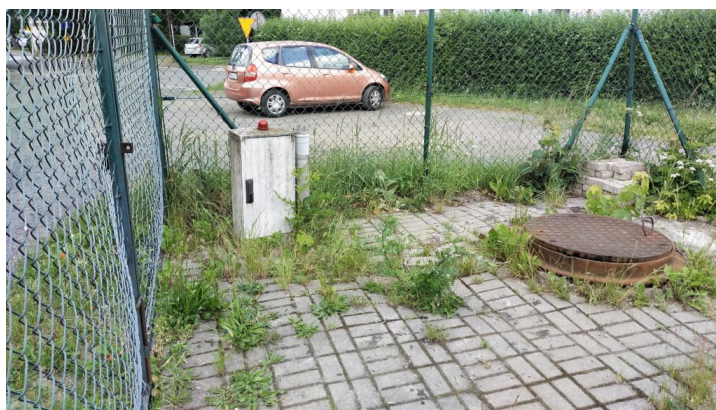
Przepompownia przy ul. Pocztovej
