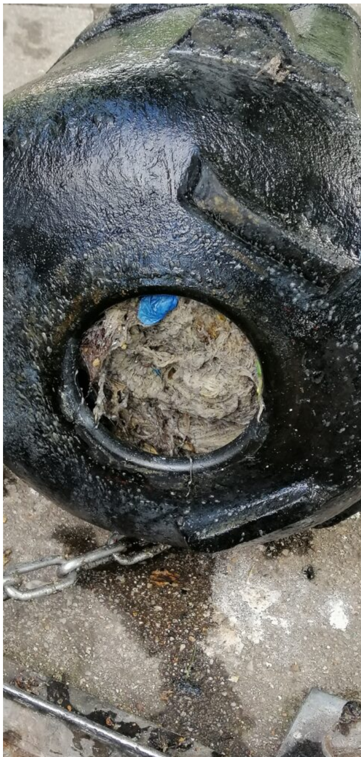
zapchany wirnik chusteczkami nawilżanymi oraz innymi odpadami
