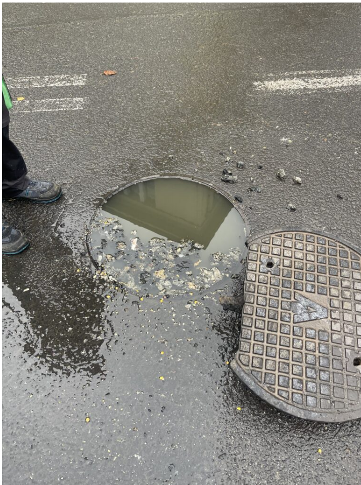
wylanie ścieków spowodowane zatorom w kanalizacji odprowadzającej ścieki z bloków przy ul. Elizy Orzeszkowej 15 i 17
