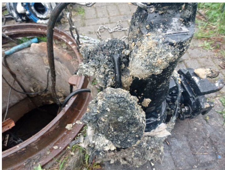
Pompa z przepompowni oblepiona stężałymi tłuszczami – ul. Poczтова
