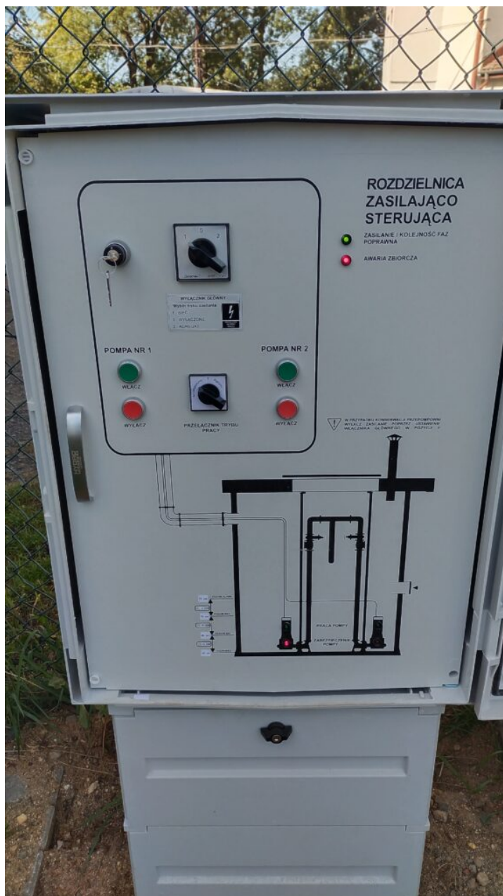
Szafa sterownicza po modernizacji (ul. Poczтова i ul. Sienkiewicza)
