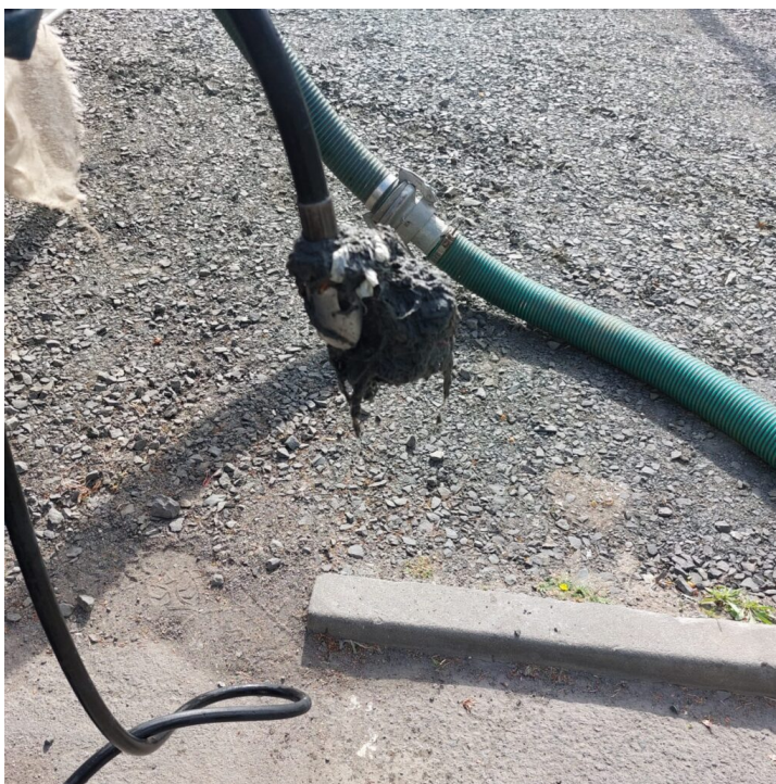
przyczyna zatoru na sieci kanalizacyjnej odprowadzającej ścieki z bloków przy ul. Elizy Orzeszkowej 15 i 17 – zbite chusteczki nawilżane
