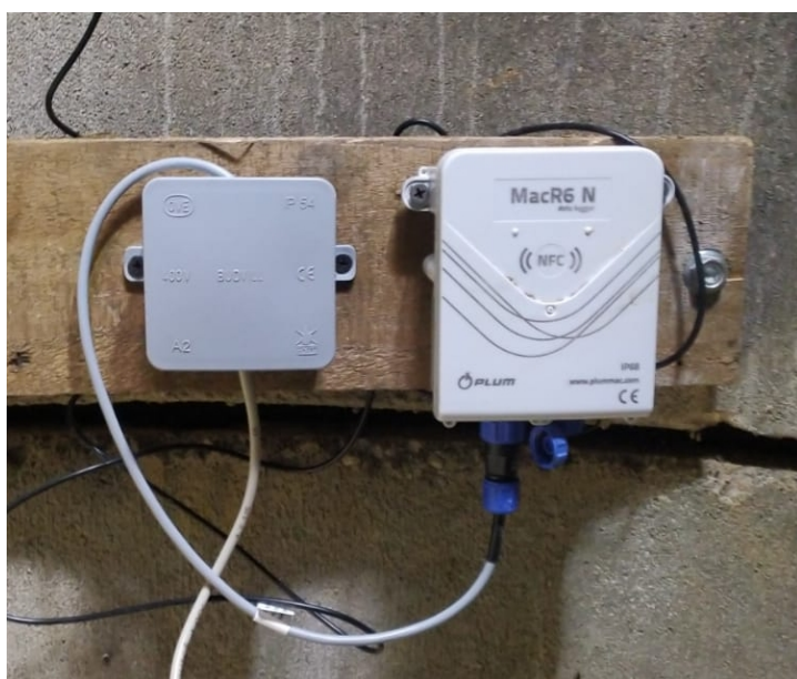
Jeden z rejestratorów zamontowany w komorze wodomierzowej
