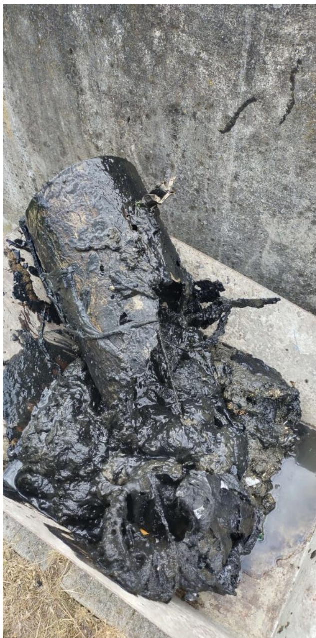
usunięta skorodowana końcówka rurociągu
