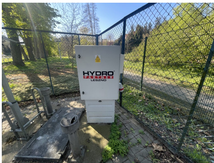
Przepompownia przy ul. Sienkiewicza po modernizacji
